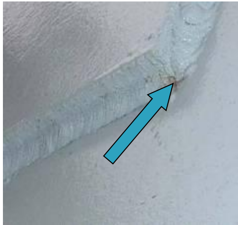
粗糙焊缝表面漏涂
